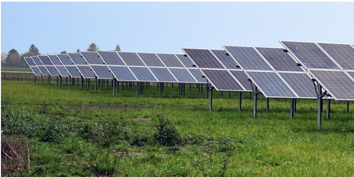
Photovoltaikanlage in Guntramsdorf, © ÖIR GmbH
